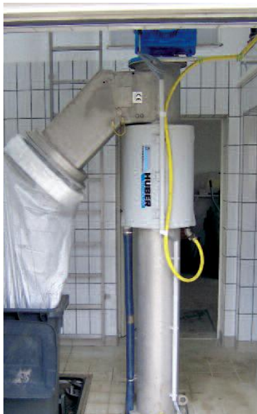
Пример установки решетки RoK4 в помещении
