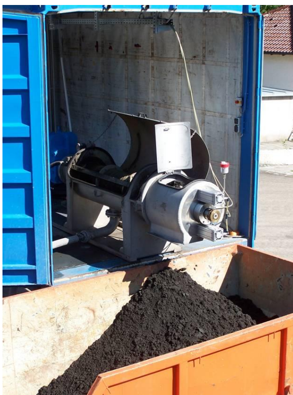
Пример установки пресса RoS 3Q280 в контейнере
