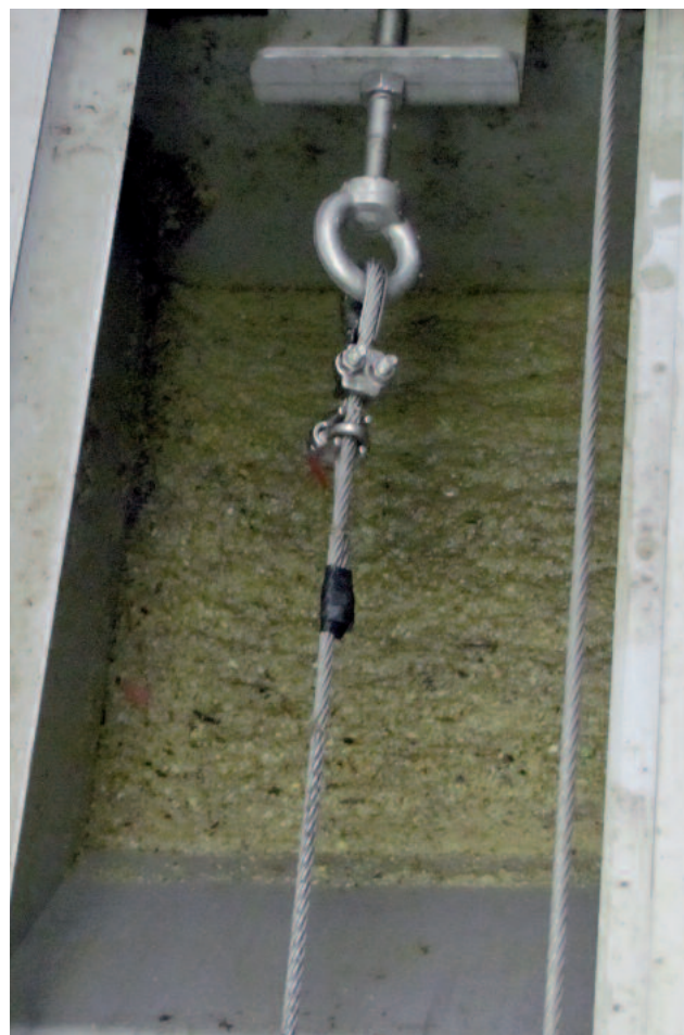
Подвижный скребок собирает плавающий слой жира в расположенный в торце накопительный резервуар для жира.
